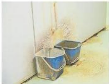
Infiltrazioni a Monte Sant'Angelo
